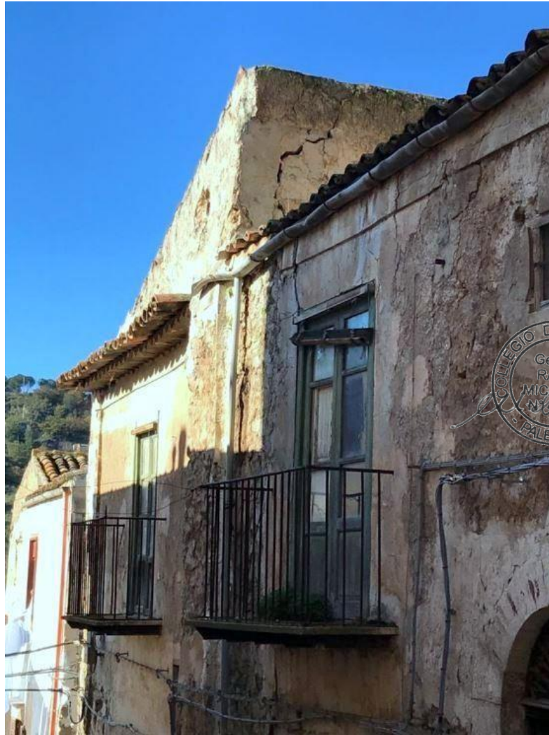
Foto n. 5 – Foto del prospetto prospiciente la via John Kennedy, dove sono presenti evidenti segni di fessurazioni, crepe e una rilevante lesione passante nella parte sommitale dell'immobile, che denota un evidente distacco della muratura con conseguenziale caduta di calcinacci e/o crollo di porzione di essa.
